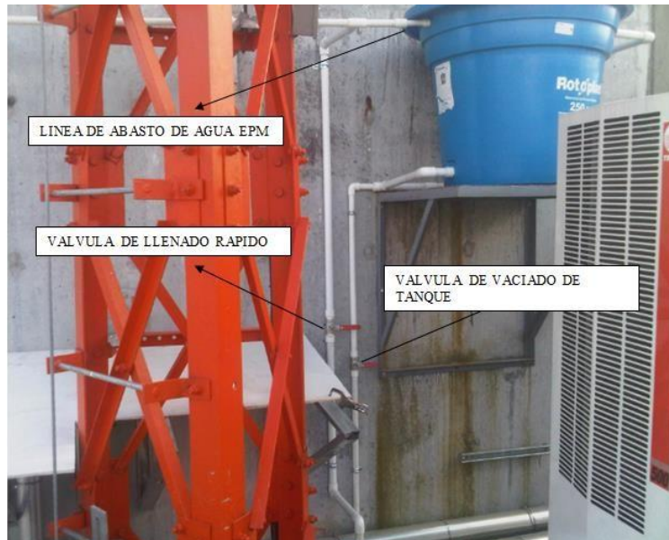
Ilustración 4. Válvulas y línea de abasto
