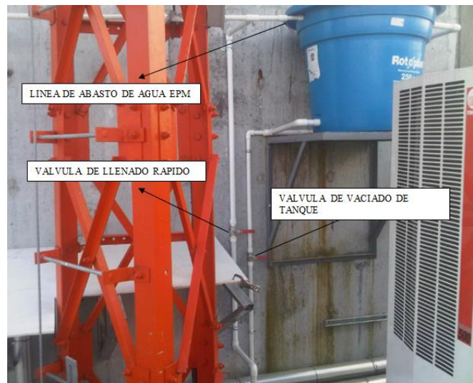
Ilustración 4. Válvulas y línea de abasto
