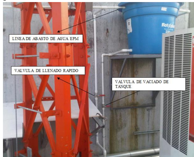
Ilustración 4. Válvulas y línea de abasto
